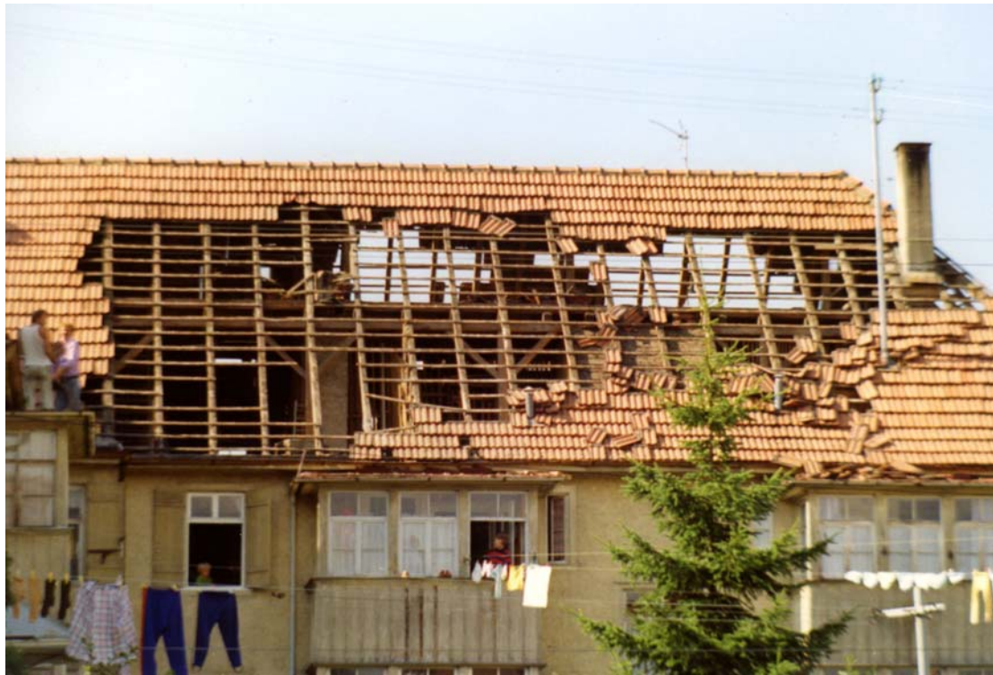
Bild 2.5: Heruntergefallene Dachziegel nach dem Erdbeben in Albstadt 1978 Foto: Peter Doll
