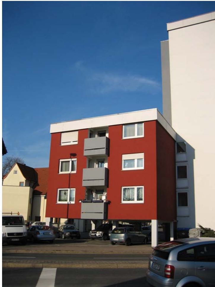
Bild 1.1: Gebäude mit schwach ausgesteiftem Erdgeschoss, mehrere Bauteile ohne Fuge verbunden und damit mit unregelmäßigem Grund- und Aufriss
