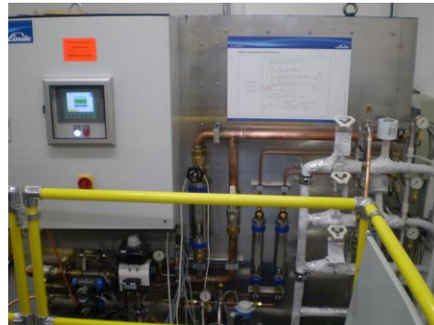
Steuerung der Kühlung
